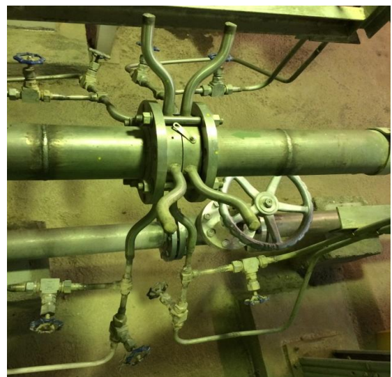
شکل ۵: طریقه نصب اریفیس دبی سنج در نیروگاه
